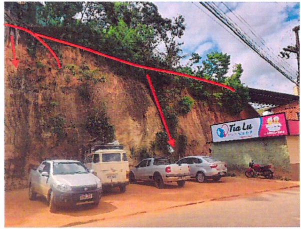
FOTO 02 – Vista geral do Talude de corte 01 que apresenta cicatrizes de escorregamentos e pontos de erosão, que deixam a inclinação do talude negativo em alguns pontos. Local utilizado como estacionamento
