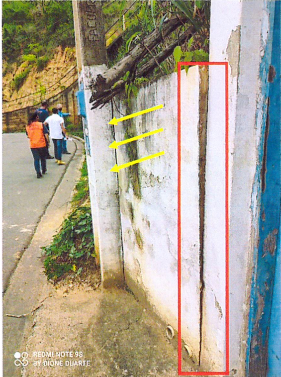
FOTO 10 – Muro de Alvenaria adernado à rua, devido às pressões exercidas pelo solo desprendido do talude.
