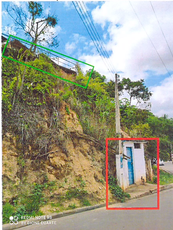
FOTO 12 – Laje / vigas em balanço e guarda-corpo do passeio. Estação Elevatória de Água da Cesan parcialmente soterrada por deslizamentos ocorridos no talude.
