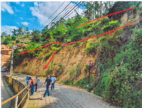
FOTO 05 – Vista do Talude de corte 03 que apresenta diversos pontos de erosão e início do pavimento intertravado de concreto
