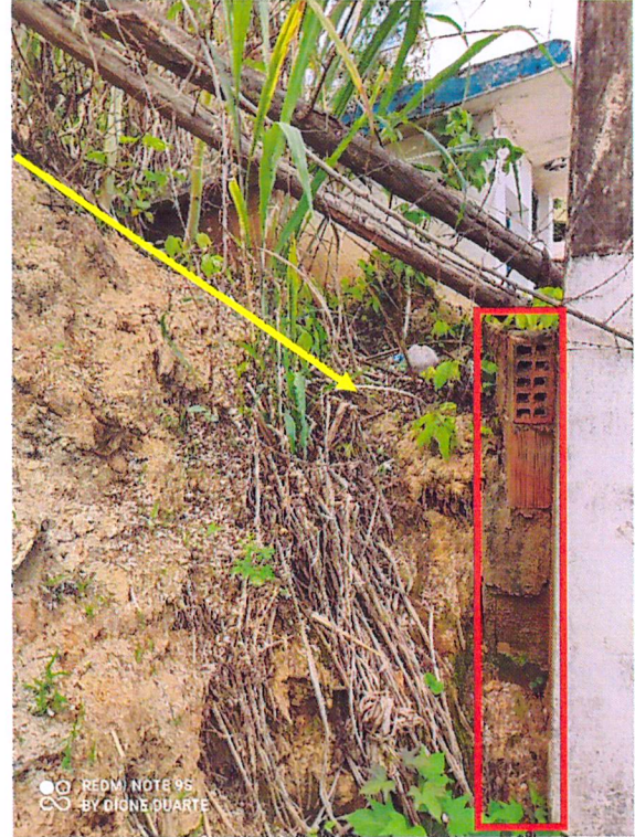
FOTO 11 – Vista por trás do muro com solo proveniente de escorregamento.
