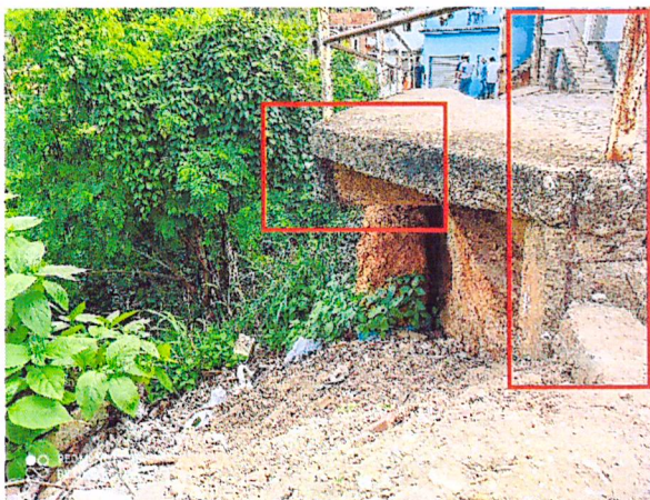
FOTO 14 – Abrasão do concreto na laje do passeio, exposição e oxidação das armaduras do pilar, viga e guarda-corpo (análise do terreno vide FOTO 07)
