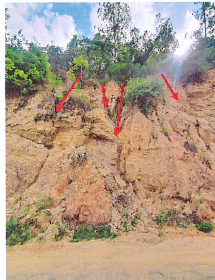
FOTO 06 – Índices de erosão superficial na face do Talude de corte 03
