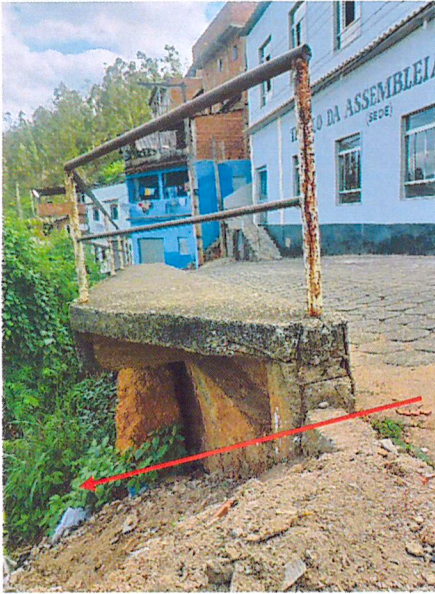
FOTO 07 – Ponto de erosão na lateral e base da calçada localizada na margem da via com pavimento intertravado de concreto e que também corresponde à crista do Talude de corte 02, identificados nas FOTOS 03 e 04
