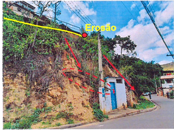
FOTO 04 – Erosão na base do pavimento, árvore caída devido à declividade do Talude de corte 02 , além de diversos pontos de erosão e raízes expostas da vegetação existente no local
